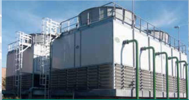
Impianto dopo la sostituzione con moduli MITA
