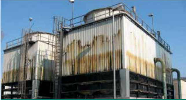
Impianto prima della sostituzione con soluzione MITA
