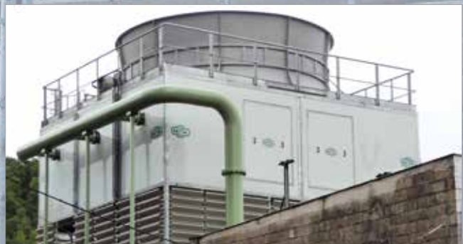
Impianto dopo la sostituzione con moduli MITA
