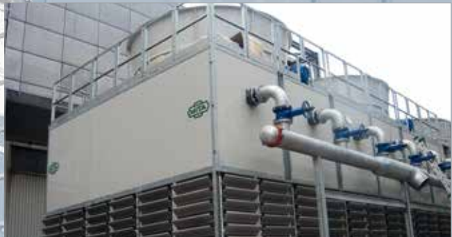
Impianto dopo la sostituzione con moduli MITA
