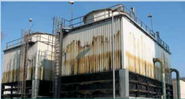
Impianto prima della sostituzione con soluzione MITA
