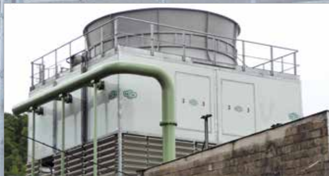
Impianto dopo la sostituzione con moduli MITA
