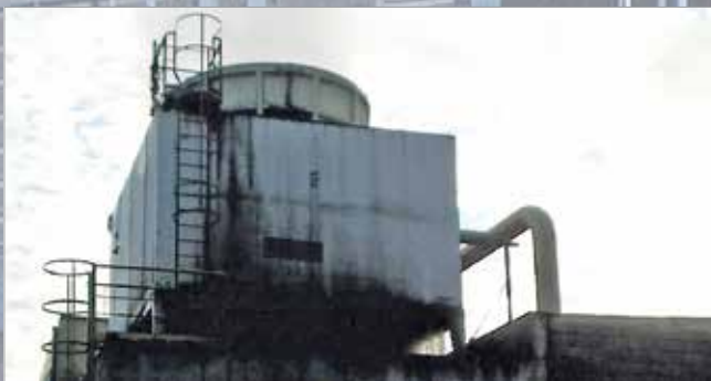
Impianto prima della sostituzione con soluzione MITA
