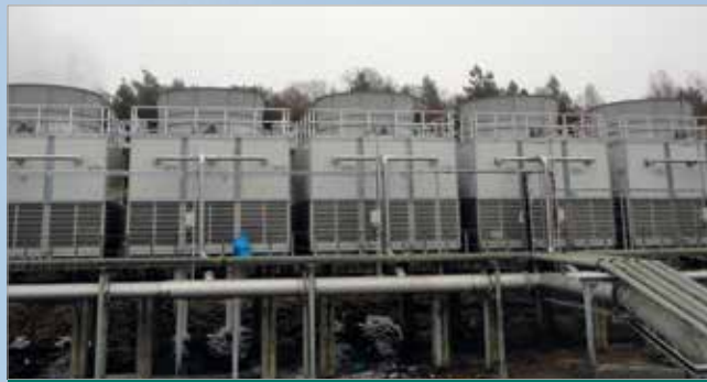
Impianto dopo la sostituzione con moduli MITA
