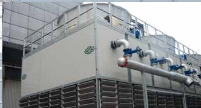
Impianto dopo la sostituzione con moduli MITA
