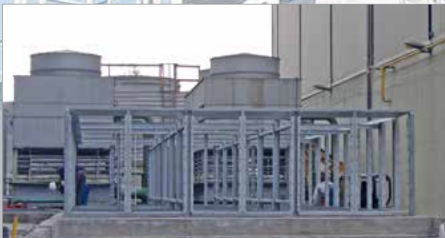
Impianto prima della sostituzione con soluzione MITA
