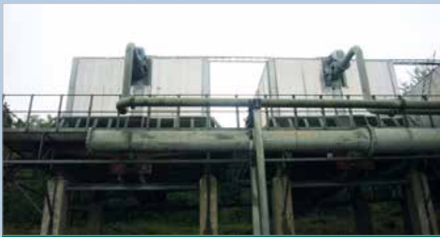
Impianto prima della sostituzione con soluzione MITA
