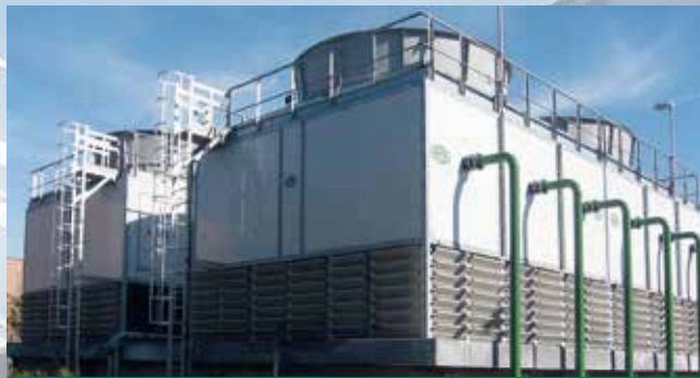
Impianto dopo la sostituzione con moduli MITA
