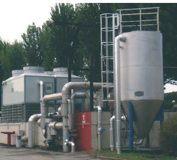
La torre di raffreddamento Mita presso lo stabilimento Clariant di Pogliano Milanese (Mi)
