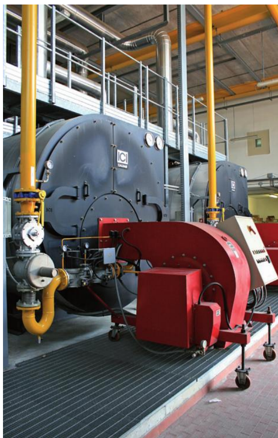
Il riscaldamento e la produzione acqua calda sanitaria sono affidati a 2 generatori di acqua calda a temperatura minore di 100 °C, di potenzialità 8.700 kW.
