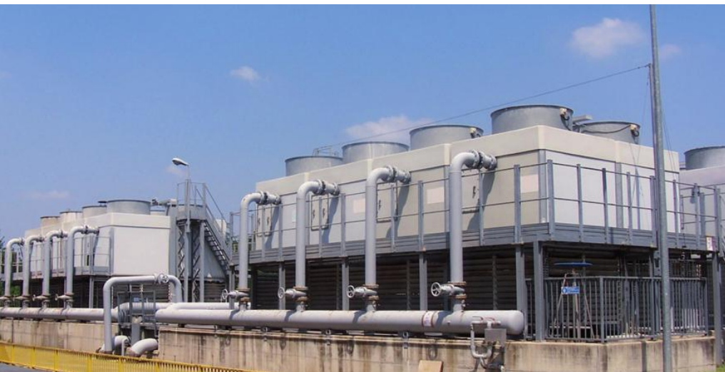
Le torri evaporative a tiraggio forzato sono raggruppate in 3 bacini di condensazione, costituiti ognuno da quattro torri affiancate, per una potenzialità nominale complessiva di 22.500.000 kcal/h.
